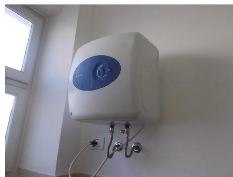
Figura 4.11 - Particolare di un boiler elettrico per la produzione di acqua calda sanitaria
